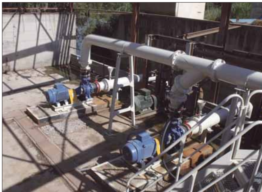
Figura 3.- Bombas de aportación a tanque de aguas limpias.
