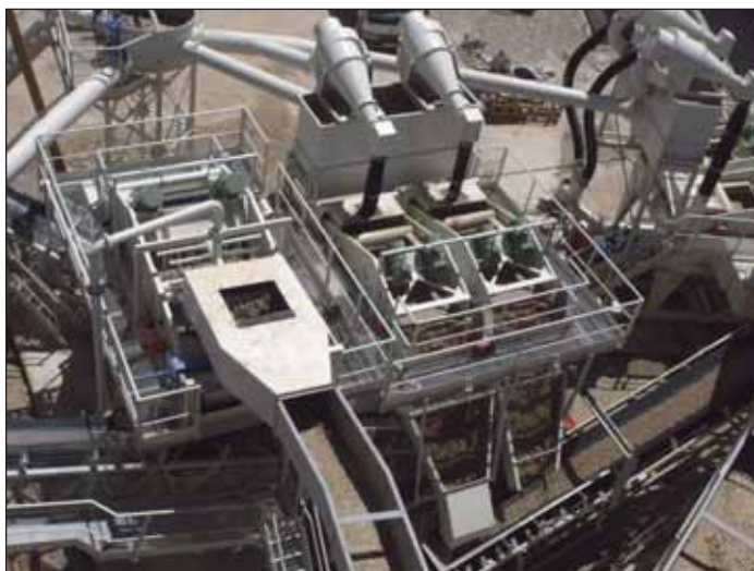
Figura 6.- Vista aérea de equipos de producción de arenas especiales 0/2 y 2/5.
