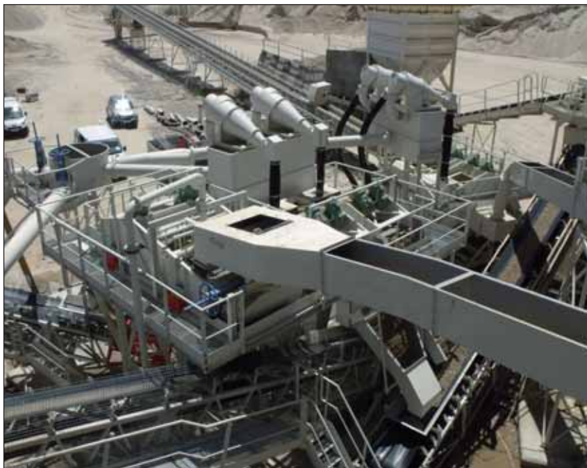
Figura 4.- Canal de alimentación a criba CV-18 x 36 con by-pass.
