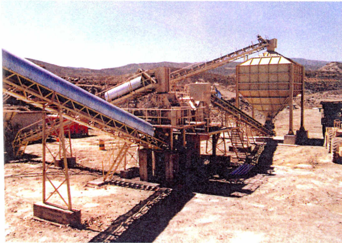
Vista de la instalación desde la criba CV-2, con la trituración secundaria y terciario.
