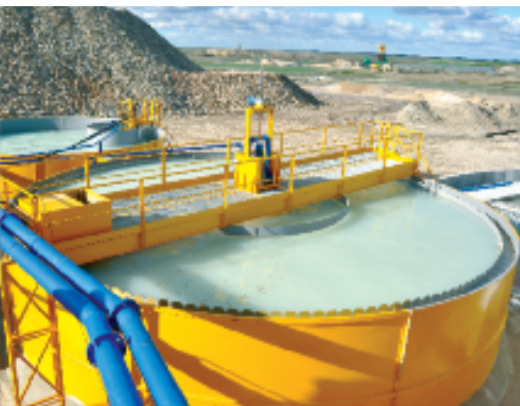
Decantador y depósito de aguas limpias.
