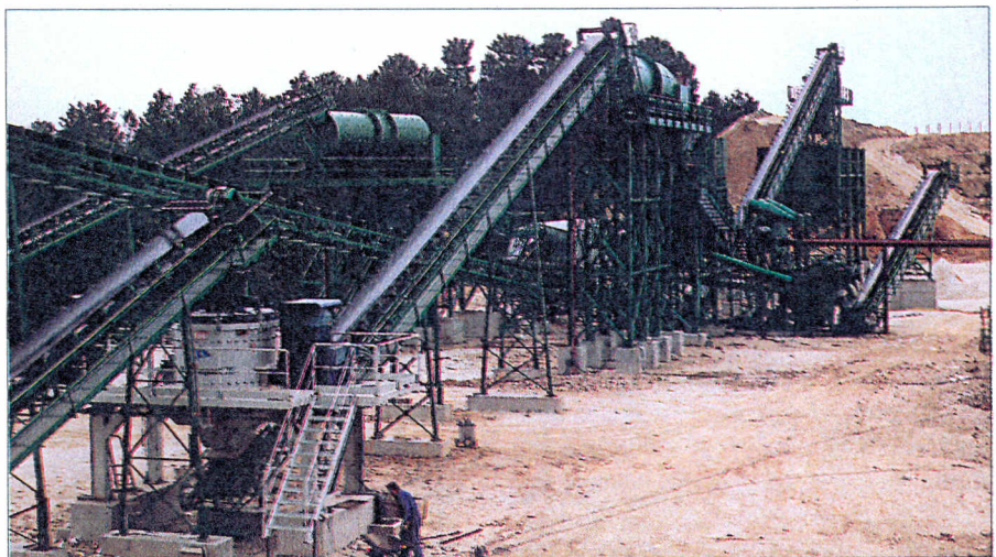
Foto 1.- Vista general de la instalación.
