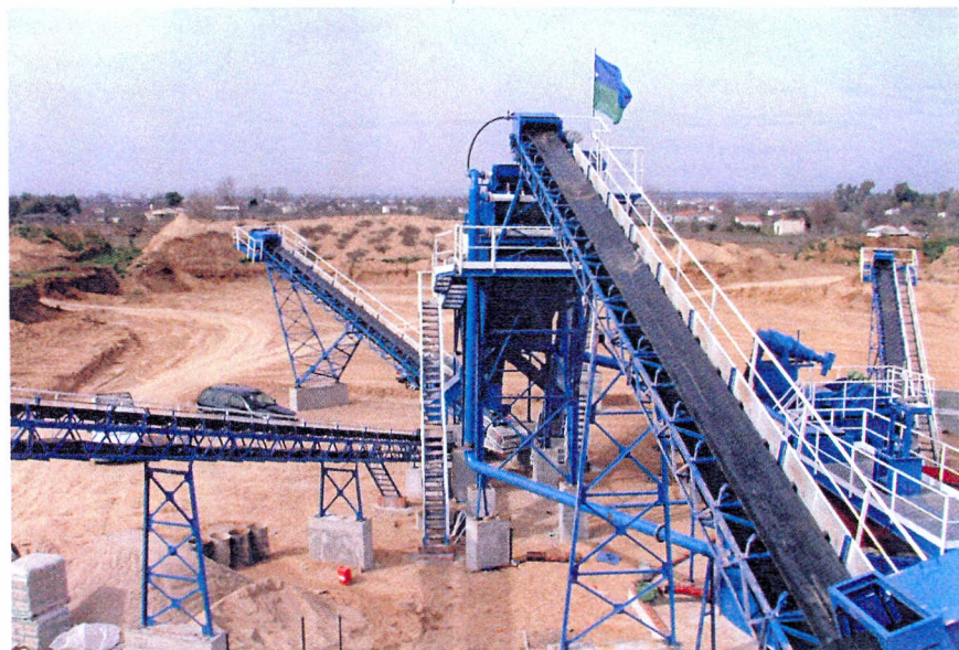
Figura 3.- Instalación vista desde el puesto primario.
